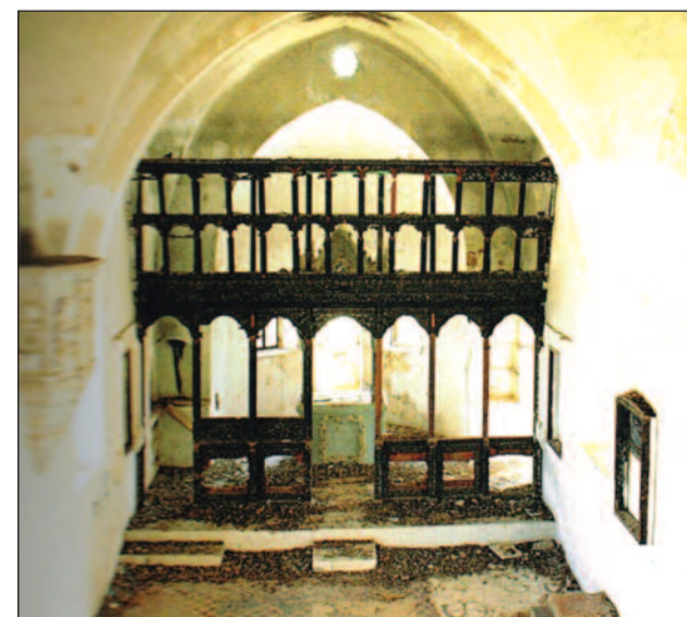
Καταστροφές στην εκκλησία της Αγίας Μαρίας στη Γιαλούσα.
